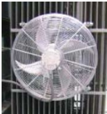
Fig. 5.10. Ventilador de Enfriamiento de Transformador
